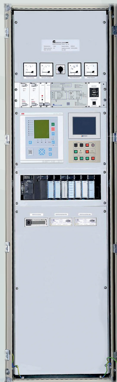
Rys.1 Szafa regulatora w ETA
